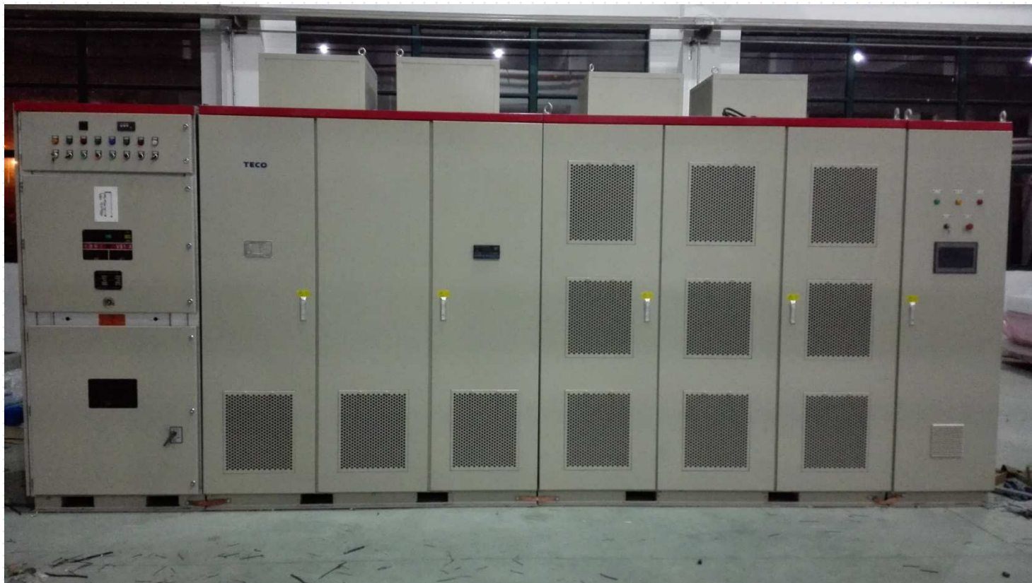
(10KV 1700KVA 中壓變頻器 )
